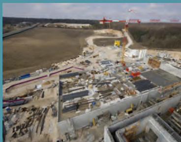
Epure, en cours de construction sur le centre CEA de Valduc, qui élargira les capacités de mesures d'Airix
