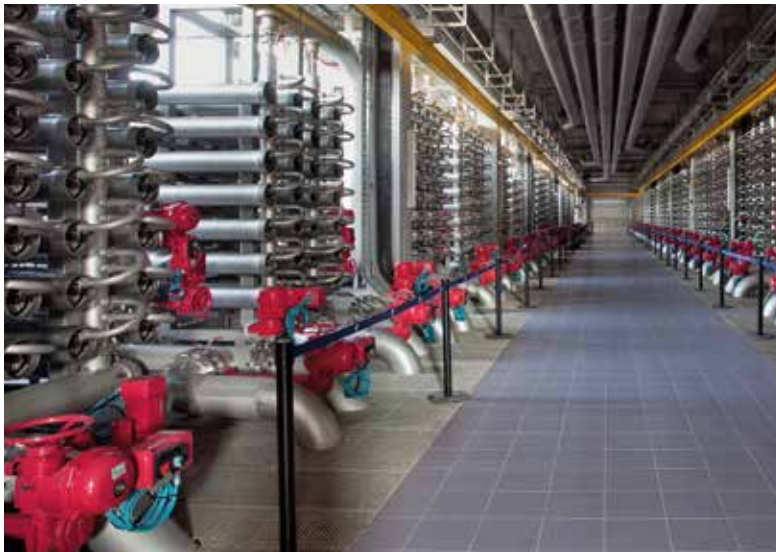
Nanofiltration à l'usine de Méry sur Oise.
