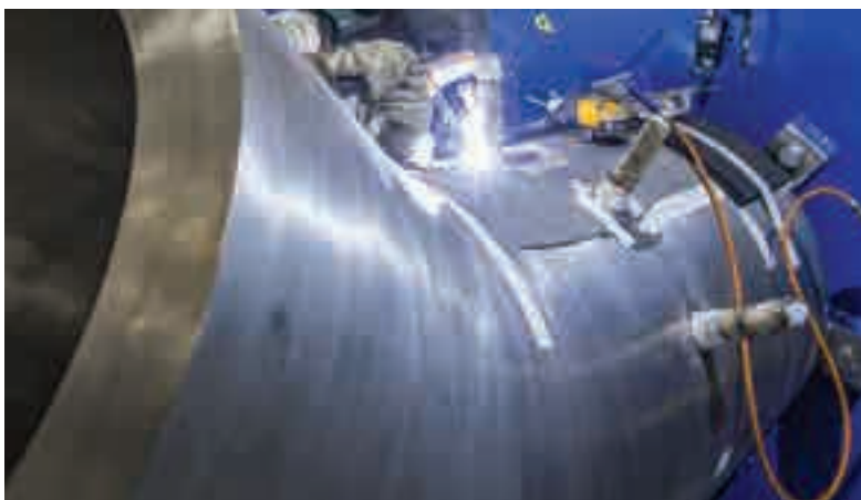
Soudage d'un piquage sur une branche en U pour le projet Hinkley Point C à l'atelier inox de l'usine Framatome de Saint-Marcel.
